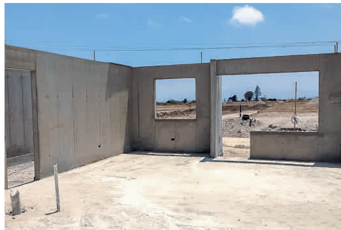
Altos del Mirador Proyecto de viviendas en Coquimbo / IV Región, Chile 100 casas de 1 piso Planta de aprox. 58 m 2 de superficie
