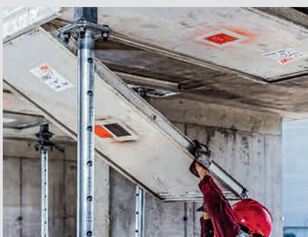
El desencofrado de las losas comienza con los paneles para losa exteriores.
