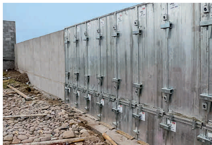
Proyecto de viviendas Mazatlán, México Muro perimetral del barrio de viviendas Muros de hormigón armado de 2,40 m de altura Ejecución con puestas de hormigonado de 12 m de largo
